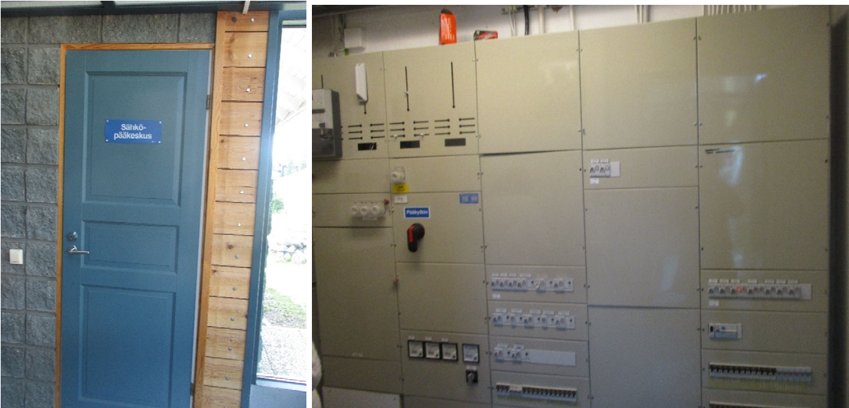
Kuva 7. Sähköpääkeskus sijaitsee kappelin pääsisääntulon tuulikaapissa
