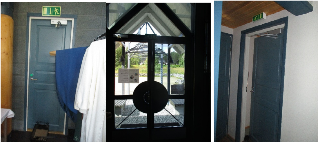
Kuva 8. Poistumistiet kirkosta asuntolan kautta ulos (välissä turvalukko) Kirkon pääsisäänkäynnin ulko-ovessa, asuntolan kautta kirkon sivulle ulos vievä reitti (3 kpl)
