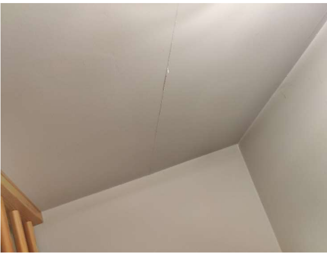
Kuva 9. vesivuodon vauriojälkiä katossa
