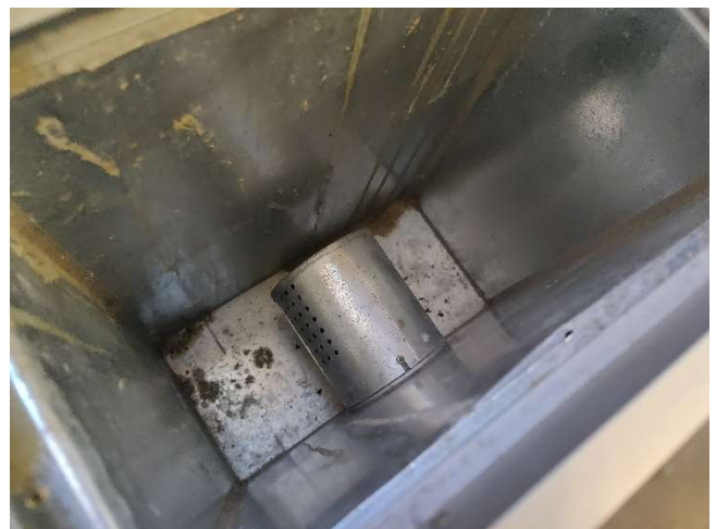
Kuva 6. lattian jakolaatikoita tulisi säännöllisesti puhdistaa
