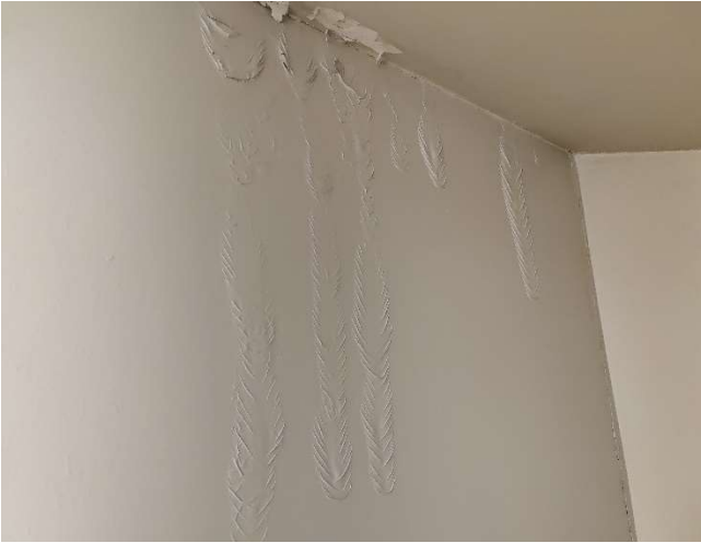
Kuva 7. makuuparven vesivuodon vauriojälkiä katon rajassa
