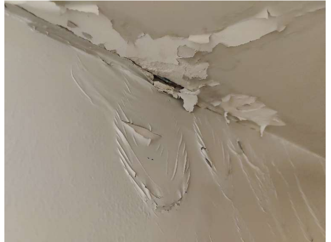
Kuva 8. makuuparven vesivuodon vauriojälkiä katon rajassa
