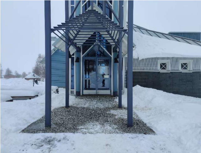
Kuva 1. vesi lammikoituu vas. puoleisen pilarin juureen
