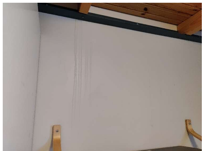
Kuva 10. vesivuodon vauriojälkiä makuuparven alapuolella
